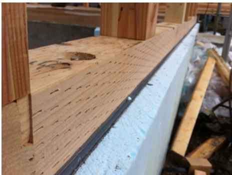
基礎の周りを断熱材（FP50mm）ですっぽりと囲い、外周部には幅900の断熱材（FP30mm）を土間下に埋込みます。
